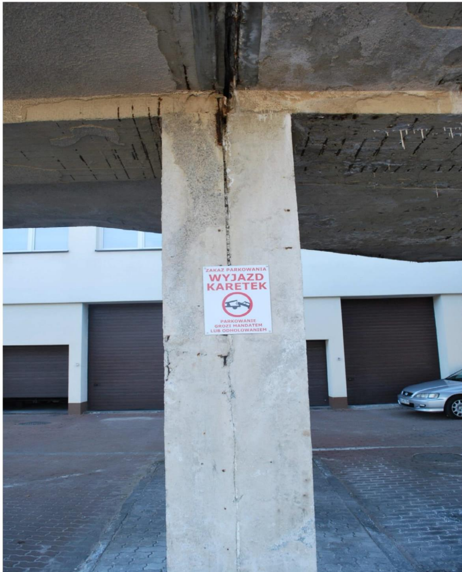
Słupy – brak tynku, stan techniczny dostateczny.
